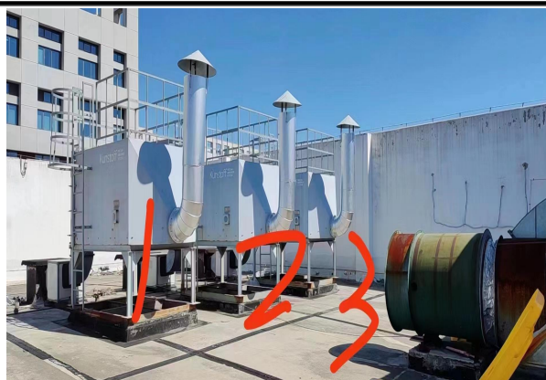
图4-3 1#排气筒、2#排气筒
