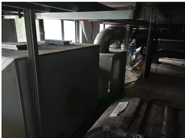
图4-2废气处理设施
